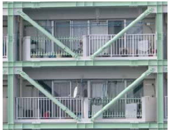
写真 2 制震ブレース
